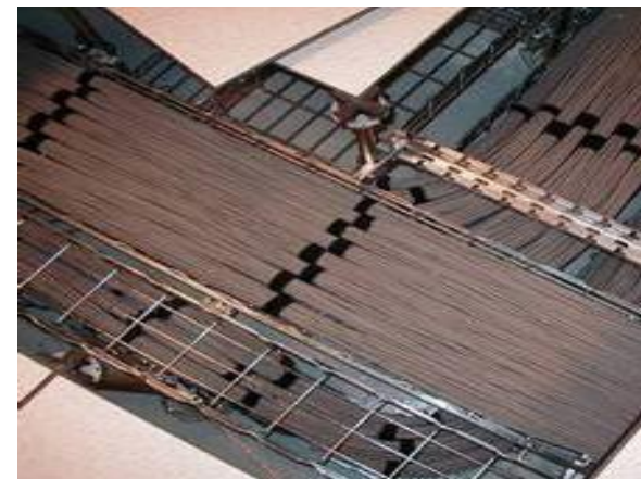
弱电线在静电地板下敷设
