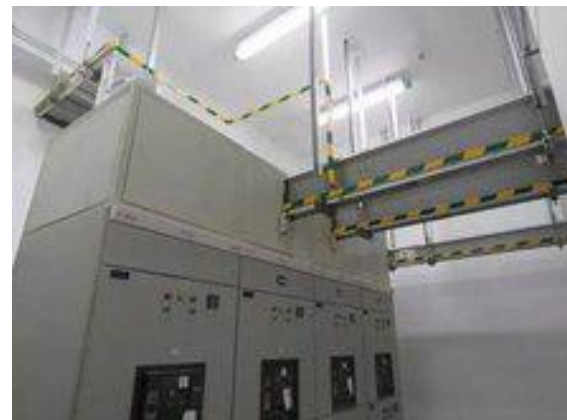
母线接地安装
