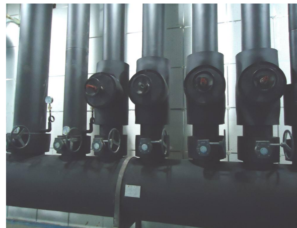
空调水系统阀门橡塑保温
