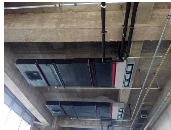
带保温风管安装
