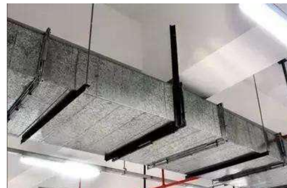
通风管道支吊架（含防晃支架）
